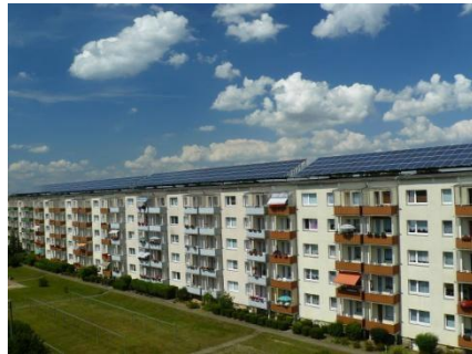
Größte auf dem Dach montierte Photovoltaik-Anlage der NEUWO GmbH
